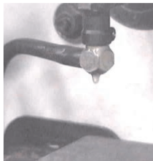
Tubulação hidráulica com vazamento.
